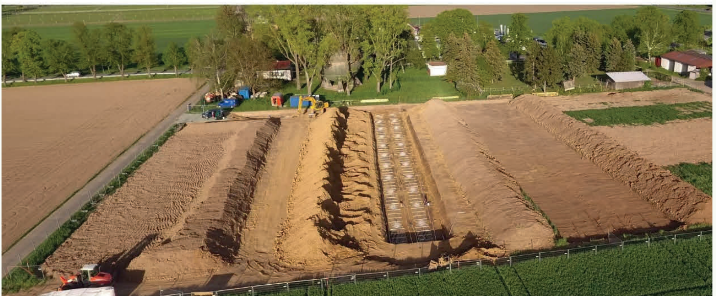
In Bad Nauheim wurde der Kollektor in offener Bauweise im Boden verlegt. In Schierling ist das Einpflügen des „Agrothermie-Kollektors“ möglich und kostengünstiger.
