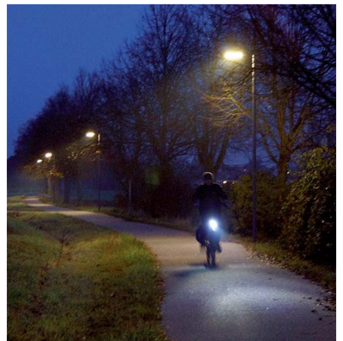
Der Geh- und Radweg zwischen Schierling und Eggmühl erhielt zur Erhöhung der Sicherheit eine „mitlaufende“ Beleuchtung
