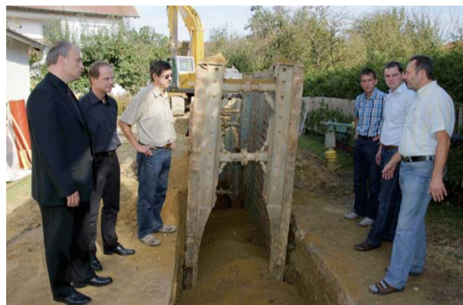
Bis zu 4,5 Meter tief wurden im Gemeindeteil Unterlaichling die Kanäle eingegraben, erläuterte Bauleiter Leutgäb (rechts)
