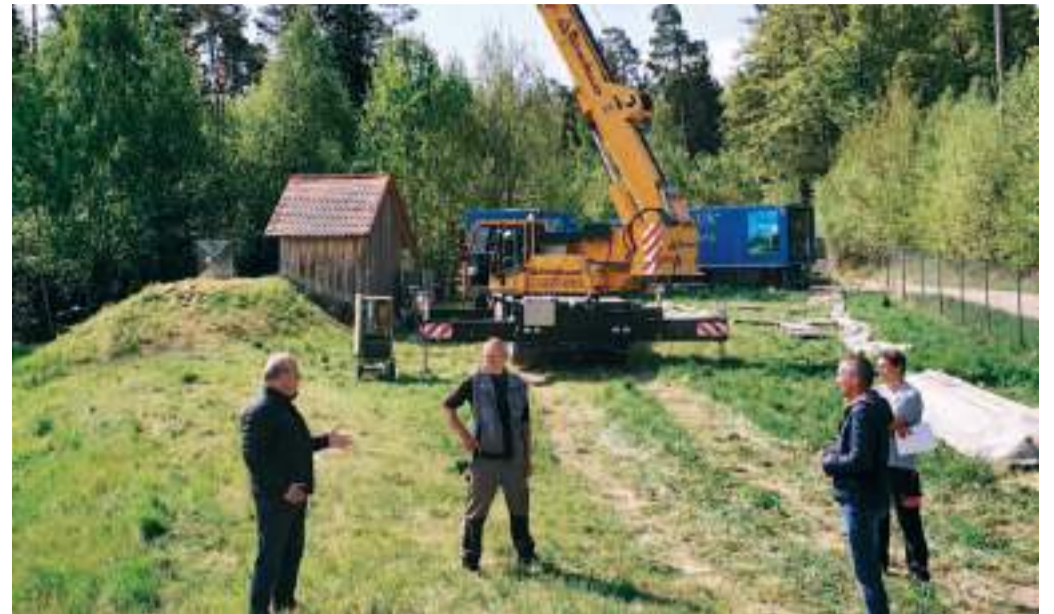
Die beiden südlich von Mannsdorf gelegenen Trinkwasserbrunnen Schierlings wurden grundlegend gereinigt und regeneriert
