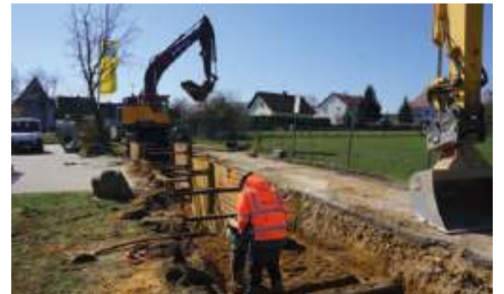
Einige Wochen musste wegen des Kanalbaus in der Labertalstraße eine provisorische Zufahrt zum Aktivmarkt geschaffen werden
