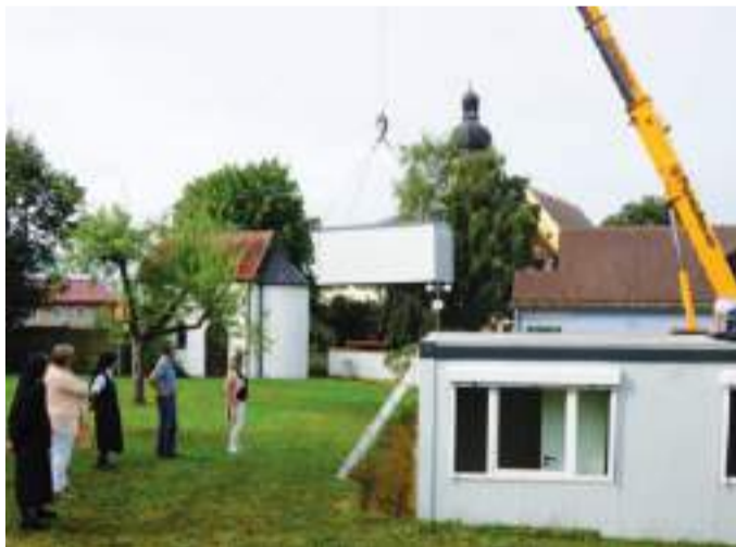
Die acht Elemente des Übergangs-Container-Kindergartens schwebten unter Beobachtung von (von links) der Schwestern Maria und Rosina, zweiter Bürgermeisterin Maria Feigl, sowie Hermann Diermeier und Nina Kellner vom gemeindlichen Bauamt an ihren Standort
